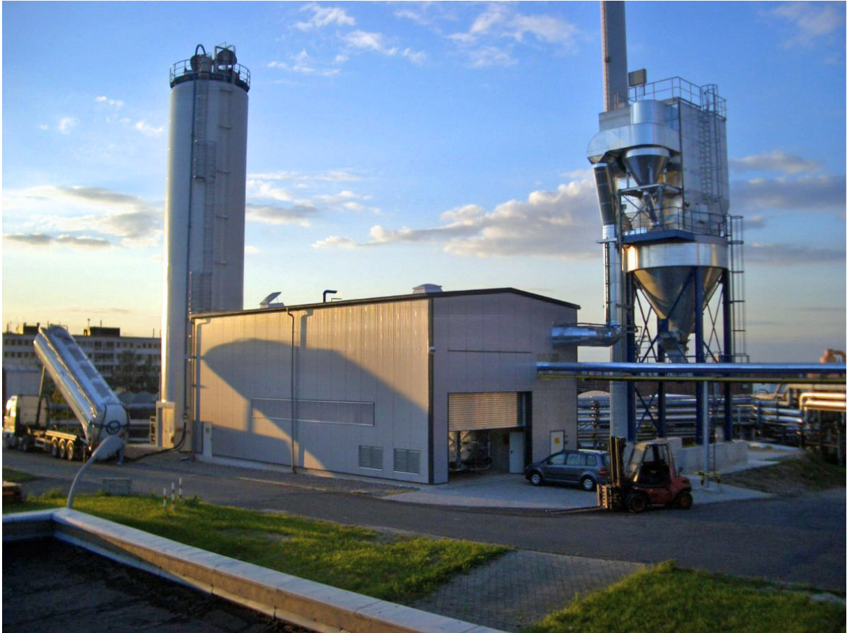
Braunkohlenstaub-Heizwerk der RESOPAL GmbH, Groß-Umstadt
